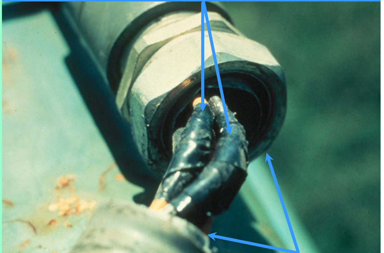
Broken Conduit Joint
